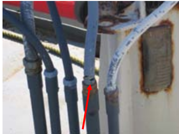
Broken conduit on davit wiring
